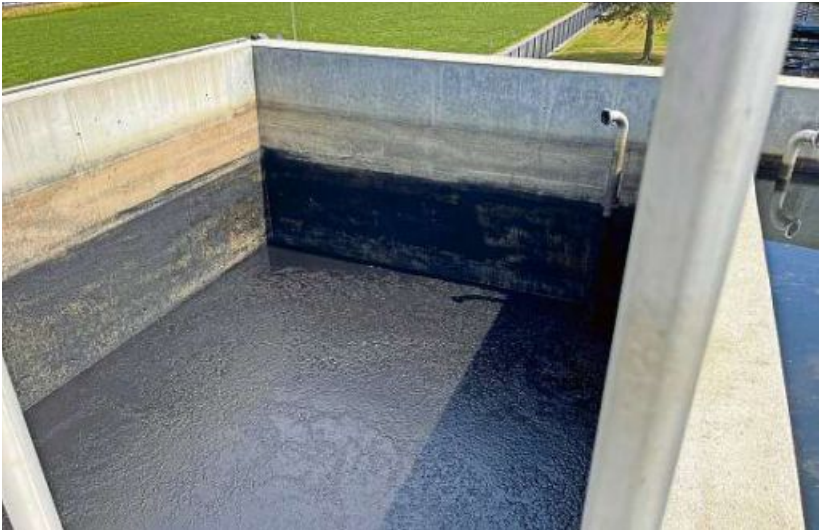
Becken mit Aktivkohle: Seit 2024 durchläuft das Abwasser einen zusätzlichen Reinigungsschritt, bevor es anschliessend in die Linth fliesst.
