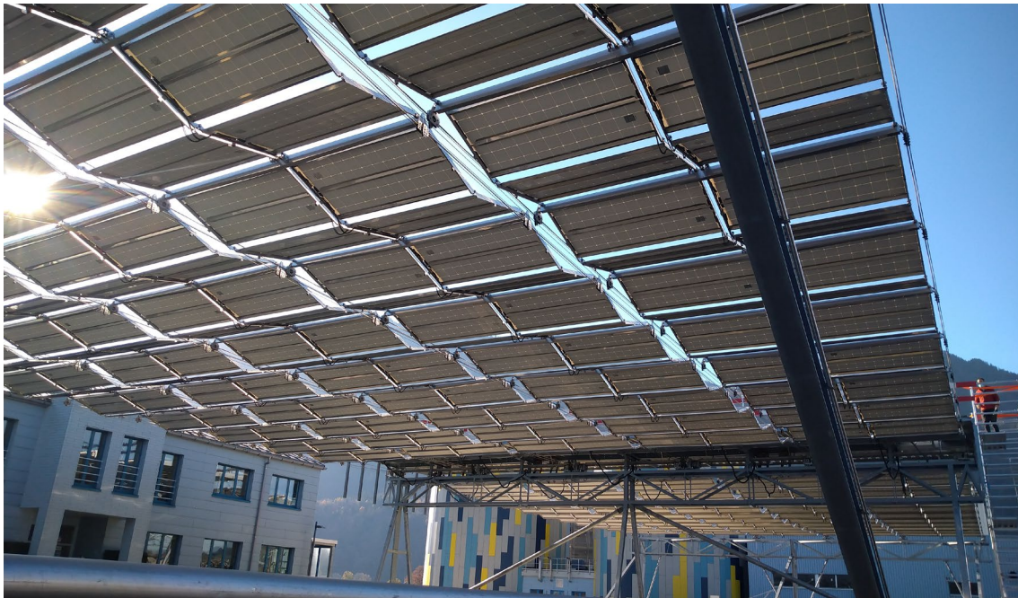
PV – Anlage über Vorklär- und Regenbecken
