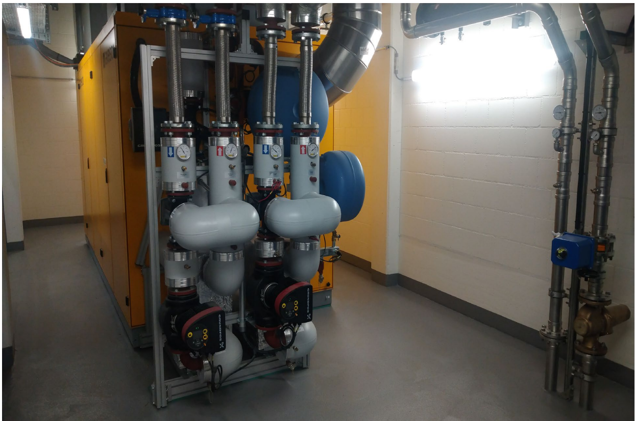
BHKW 3 mit Wärmeverteilung
