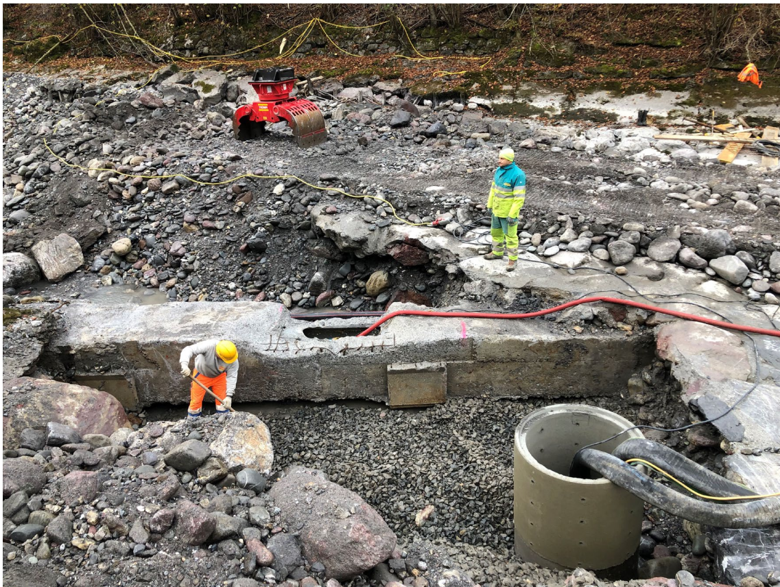
Verbandskanal mit freigelegter Schadstelle
