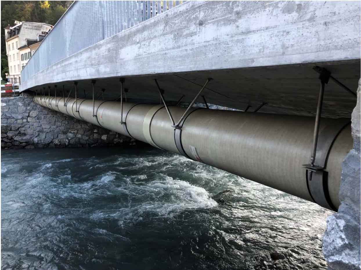
GFK-Abwasserrohr DN 700 unter der Linthbrücke Nord
