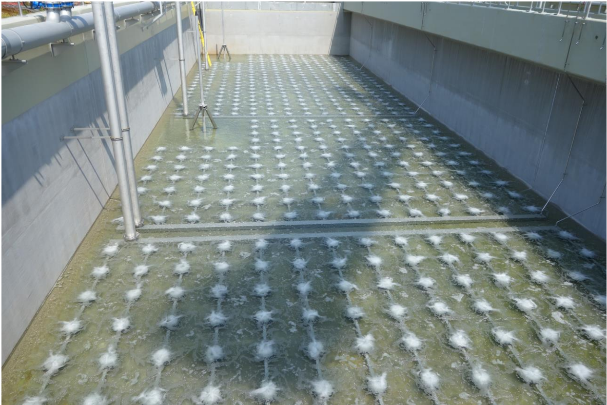
Testlauf der Belüftung im Biologiebecken
