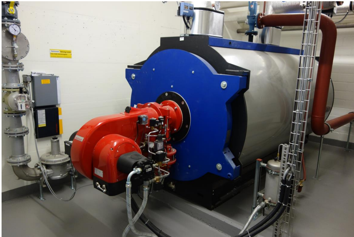
Neue Heizungsanlage 1'000 kW Wärmeleistung mit Kombibrenner Klärgas/Öl
