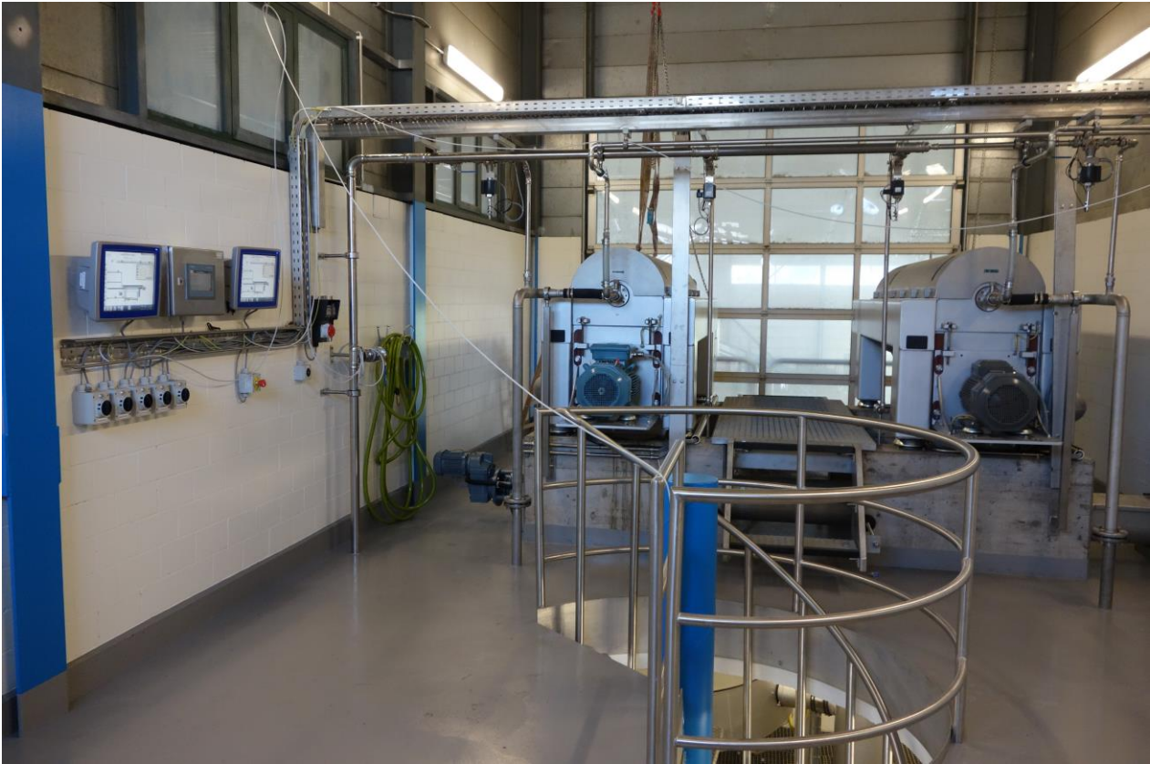
Neue Schlammentwässerungsanlage mit 2 Dekantern
