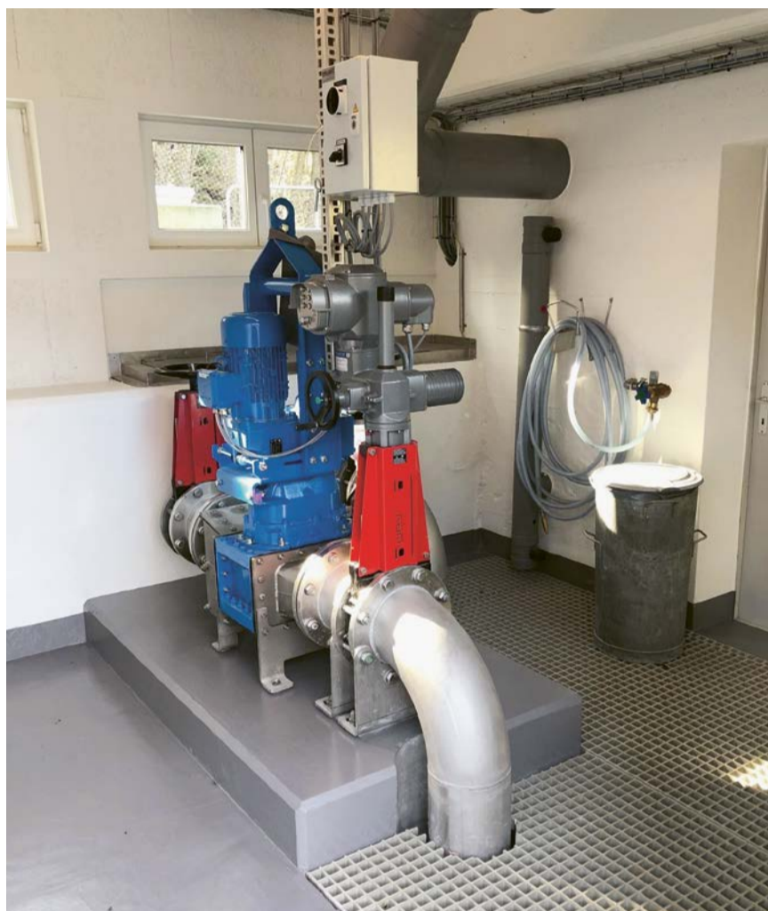
Zerkleinerer Ablaufleitung RKB Filzbach
