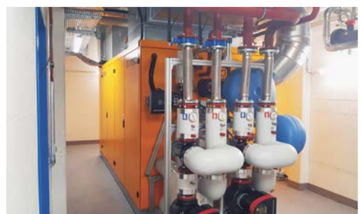
Unser drittes Blockheizkraftwerk
